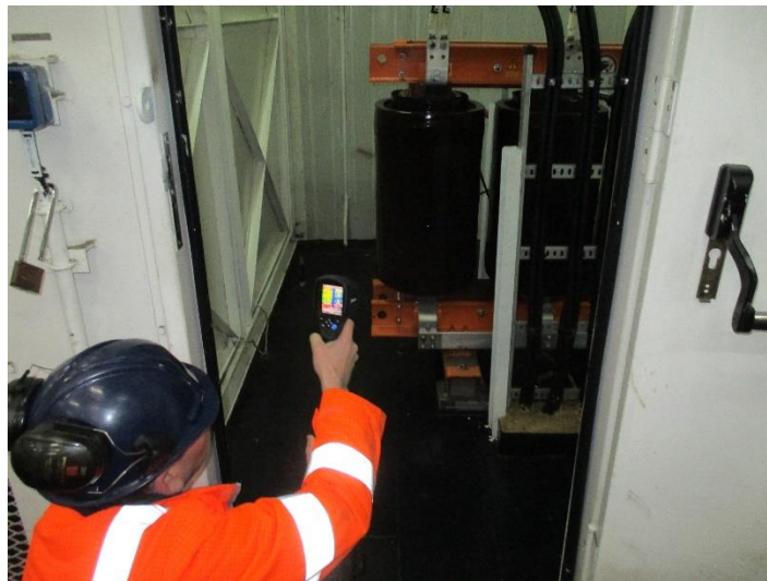
Thermografie van transformatoren 10kV/400V
