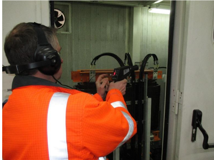
Ultrasounddetectie van transformatoren 10kV/400V
